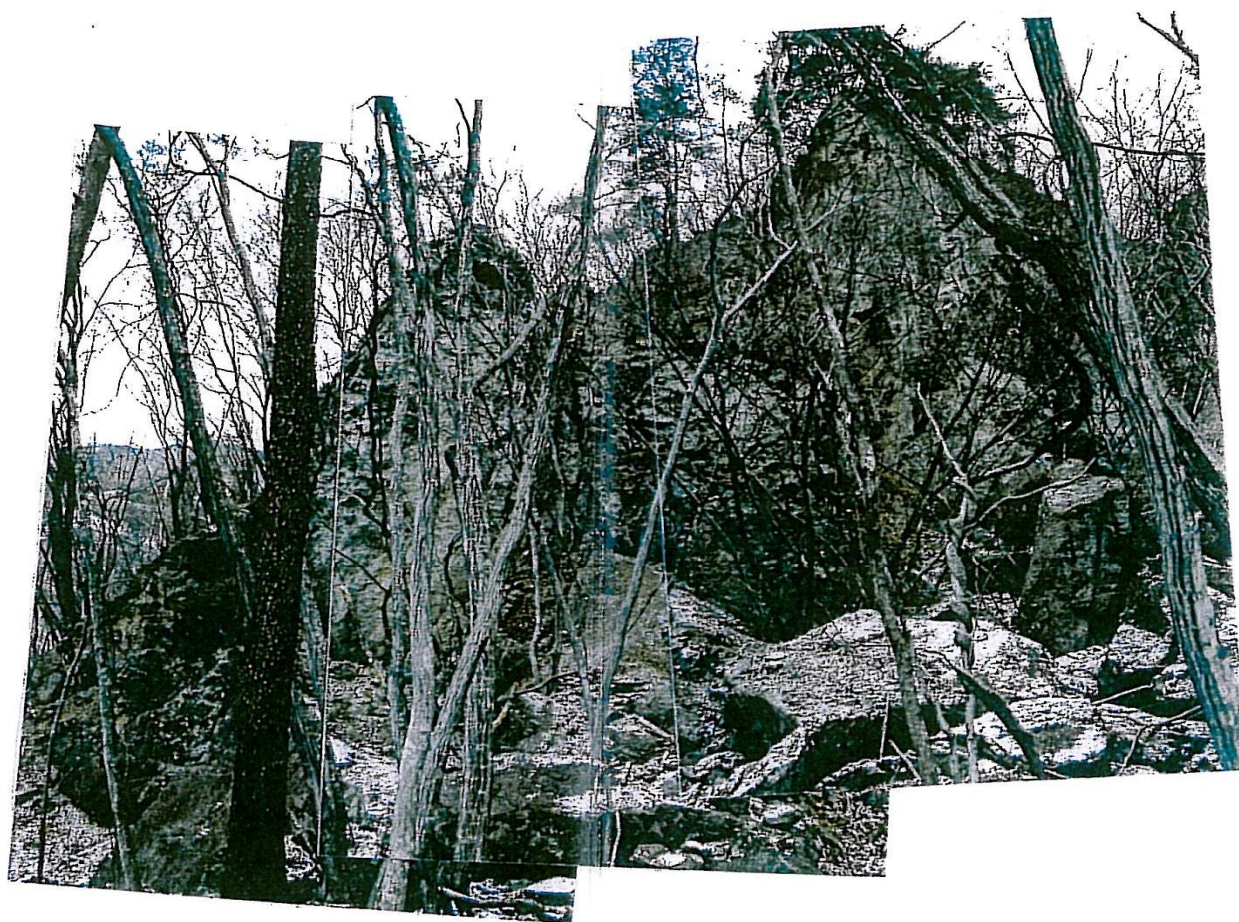
P-6 急崖部の突出部の状況 岩盤はゆるみが行進し、不安定化している。
